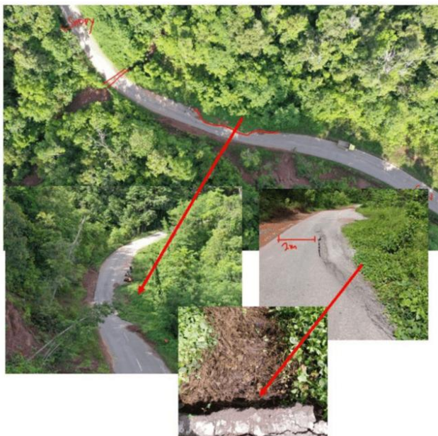
Gambar 4 Kondisi Existing Longoran
